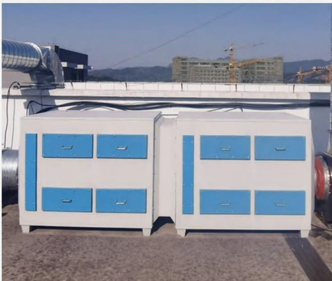
图 3.2-2 废气处理设施照片
