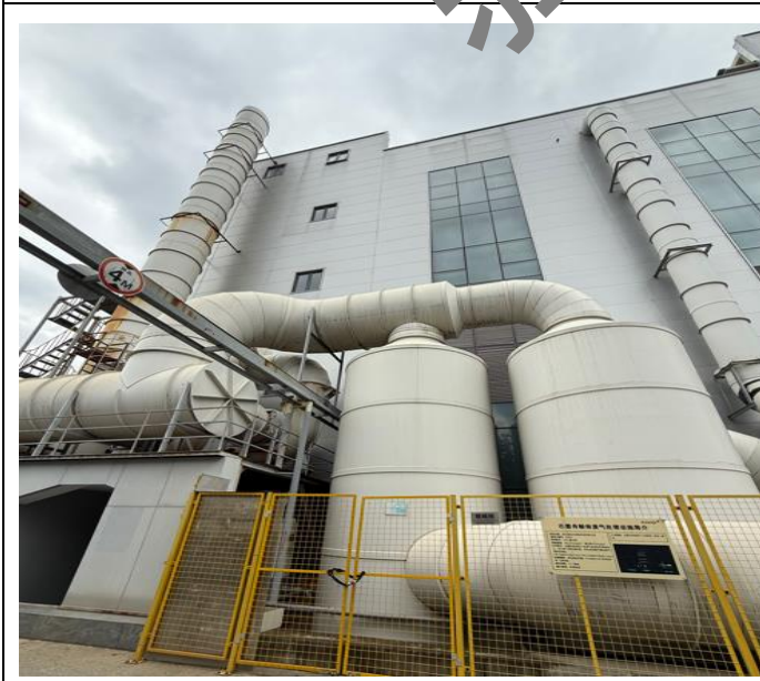
一级碱喷淋塔 11# (DA021)
