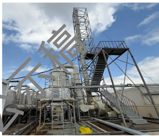
含氨尾气除杂系统 4 (DA014)
