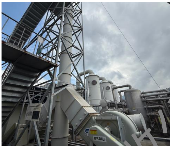
含氨尾气除杂系统 3 (DA013)
