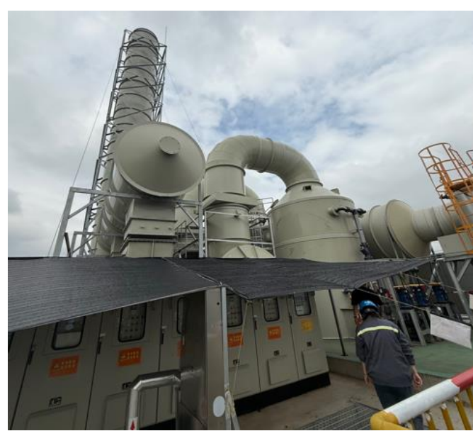
一级碱喷淋塔 6# (DA016)
