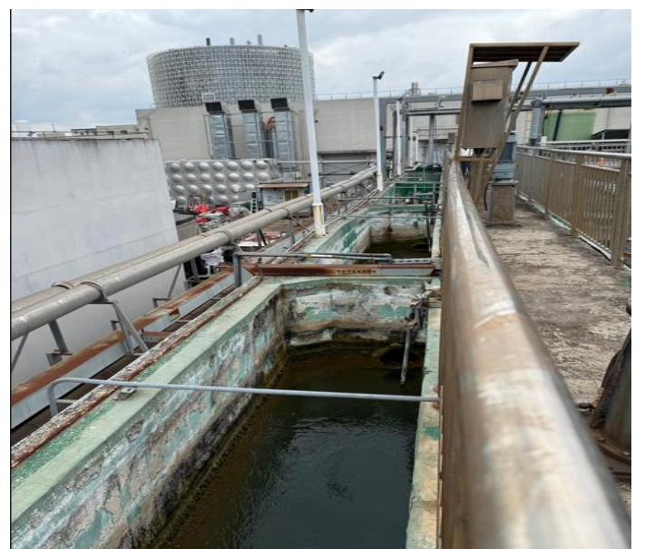
稀碱废水反应池
