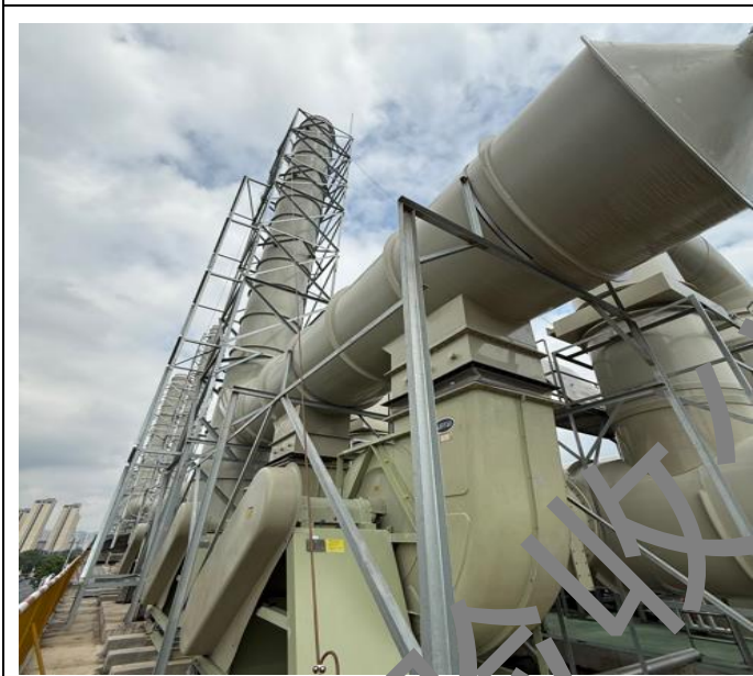
一级碱喷淋塔 9# (DA019)
