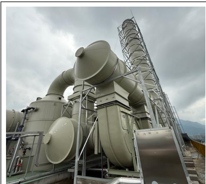
一级碱喷淋塔 7# (DA017)
