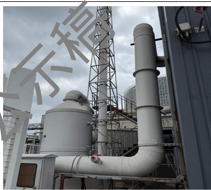
一级碱喷淋塔 10# (DA020)
