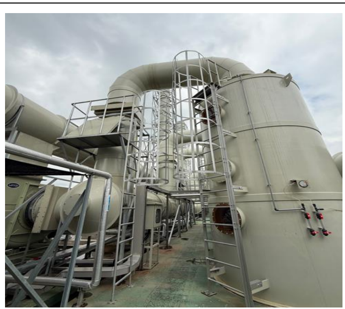
一级碱喷淋塔 8# (DA018)
