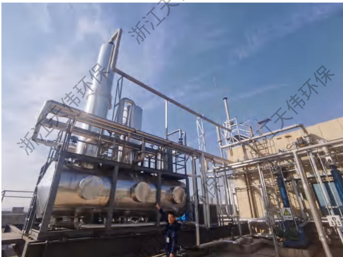
图3.2-3A厂区2级膜吸收废气处理设施（新建）
