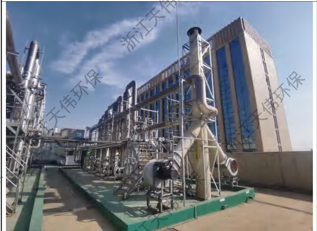
图3.2-5A厂区6#外延废气处理设施（新建）
