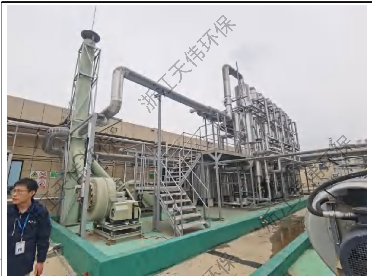
图3.2-4A厂区5#外延废气处理设施（现有）
