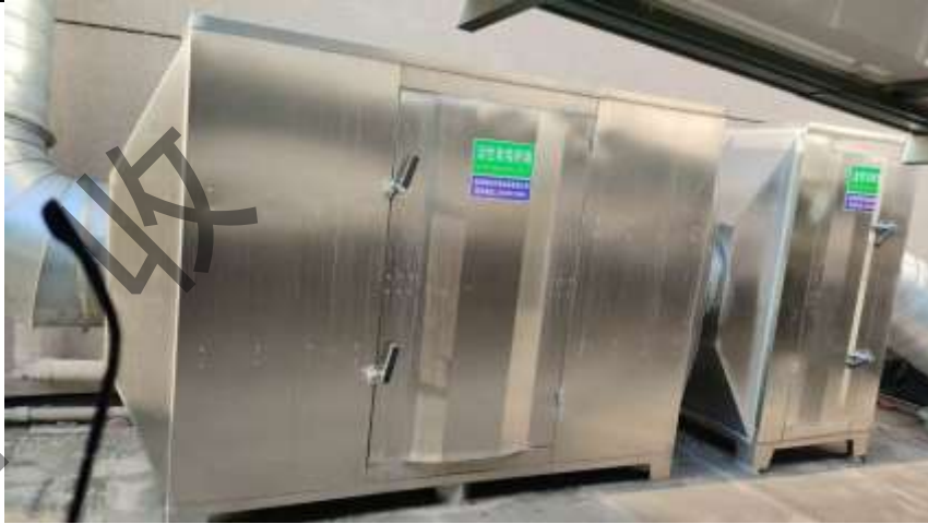
图 3.2-1 废气处理设施照片
